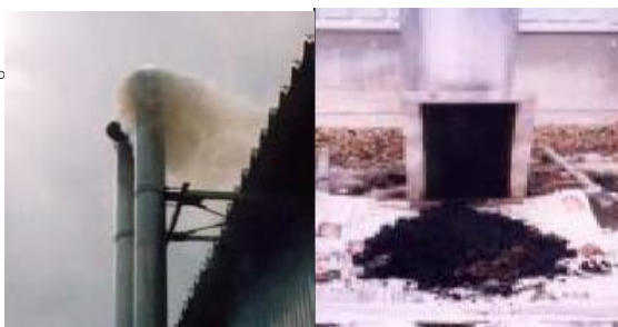
不完全燃焼時の煙 煙突に付着したスス (注) 岩手県林業技術センター提供
