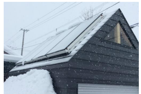
屋根に設置された太陽熱パネル
